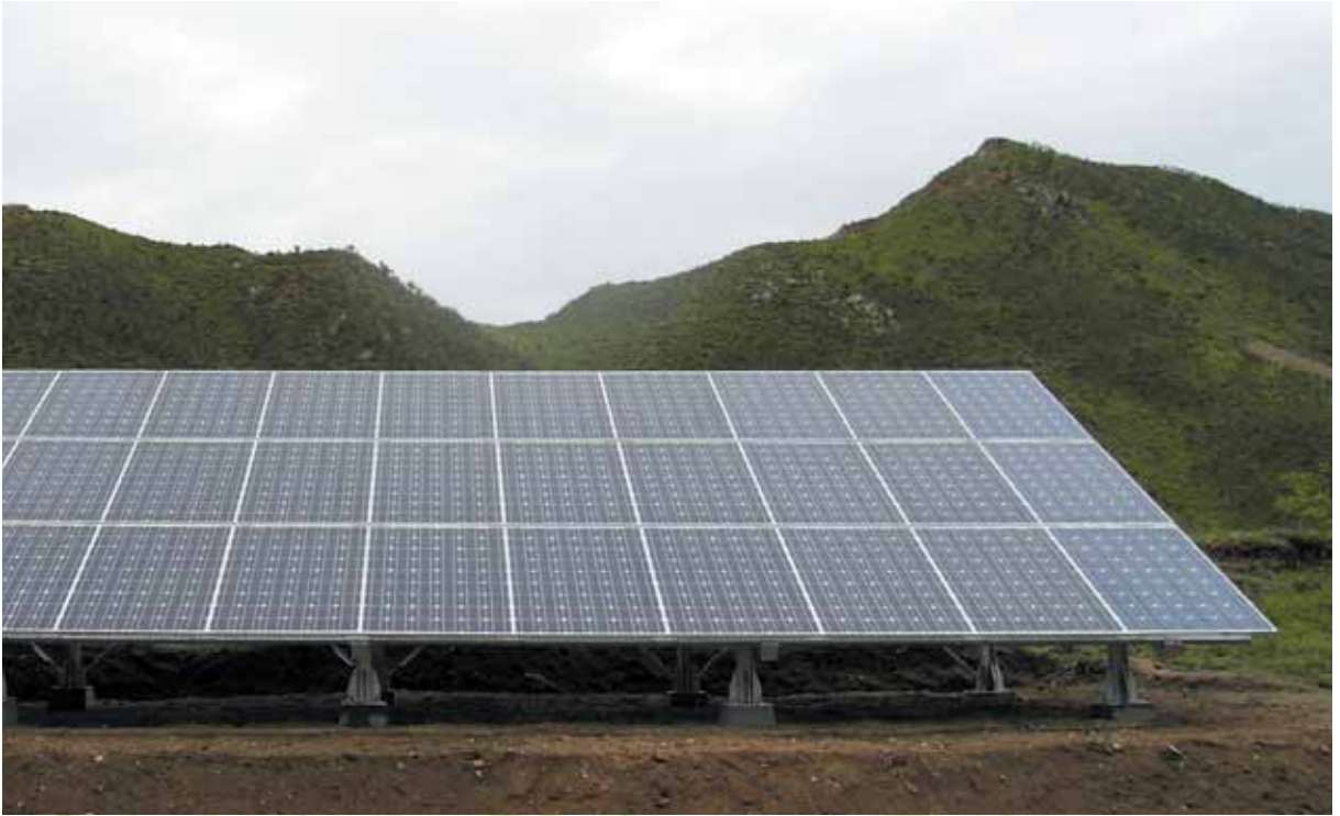
우리민족서로돕기운동과 경기도의 지원으로 개성시 개풍양묘장에 설치된 태양광 발전기
